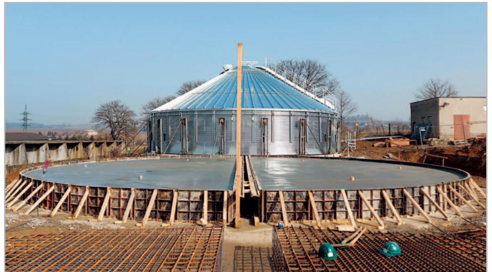
Zahájení stavby v lednu letošního roku speciálním založením a zhotovením spodní stavby, které má za cíl stabilizovat podloží pro výstavbu velkokapacitních obilních sil. Foto archiv společnosti Pawlica
